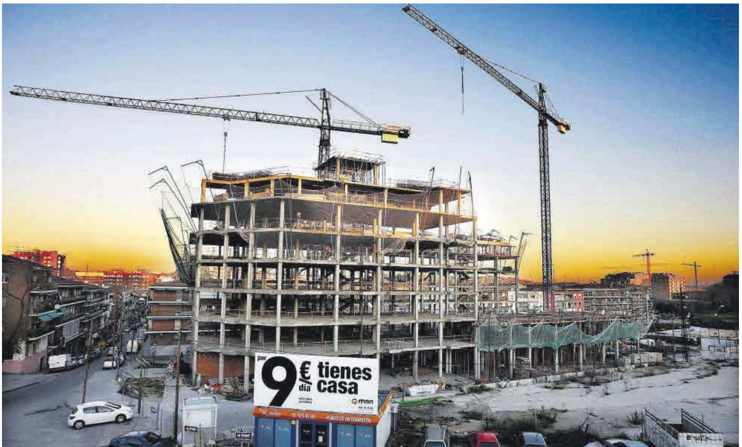
Construcció de pisos de protecció oficial de l'Ajuntament de Barcelona a la plaça de les Glòries. / FERRAN NADEU
